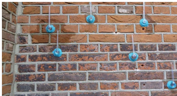
Fig. 4. Karstenbuisjes op baksteen en op de overgang tussen baksteen en voegmortel.
