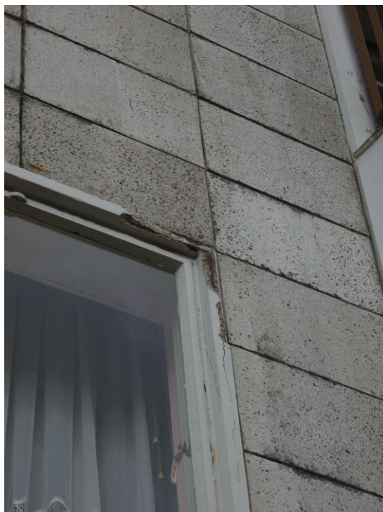
Fig. 4.4. Wapeningscorrosie aan het betonnen raamkader.
