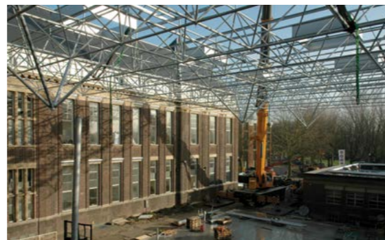
Figuur 13: De twee serres zijn bijna geheel reversibel toegevoegd om functies te huisvesten die niet in het oorspronkelijke gebouw onder te brengen waren. Foto: Wido Quist (2008)
